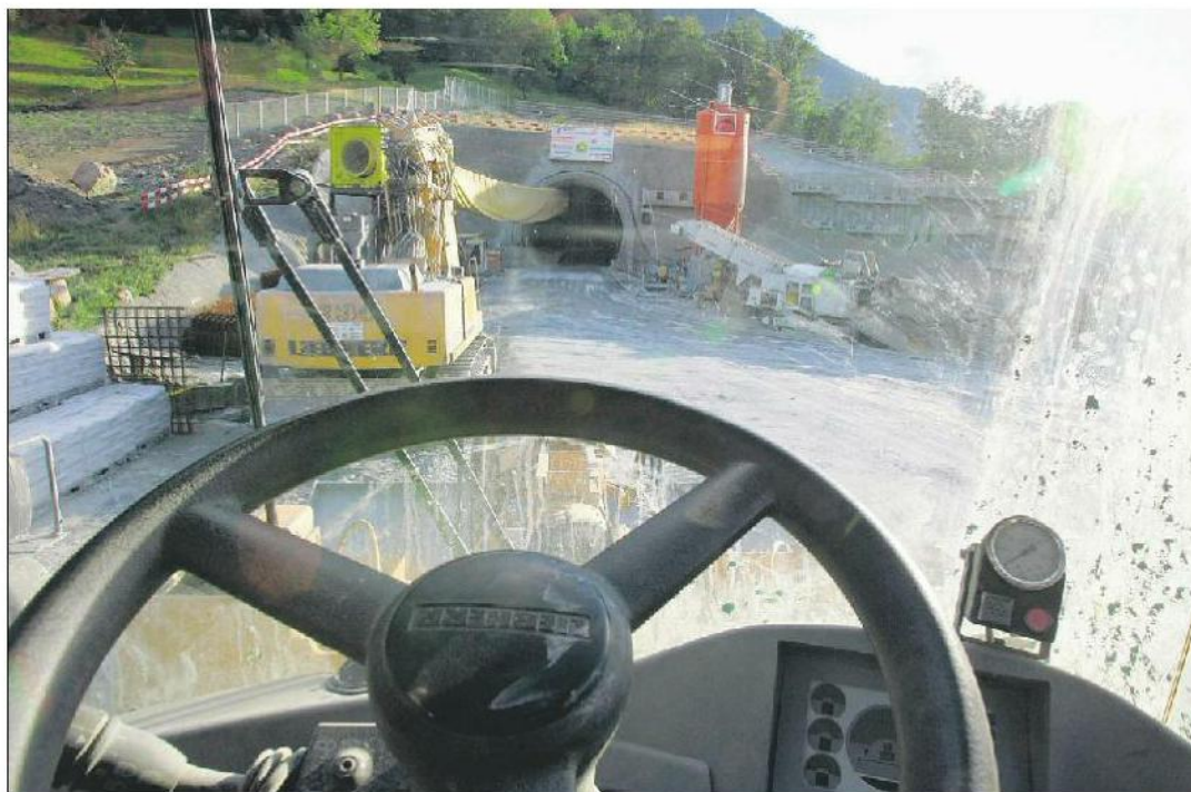
Neu wählt der Bund die Firmen aus, die auf Autobahn-Baustellen Arbeiten ausführen. OLIVIER MAIRE / KEYSTONE
